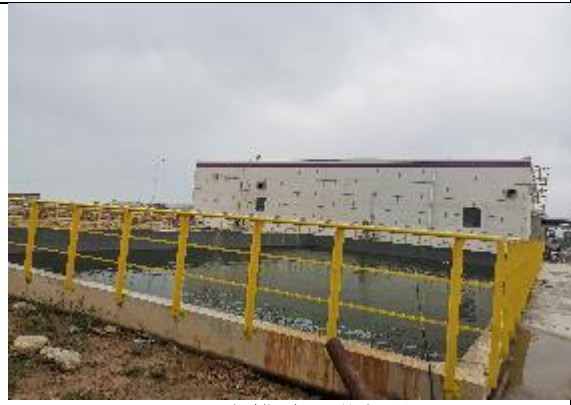
(20) 污水排放口监控池
