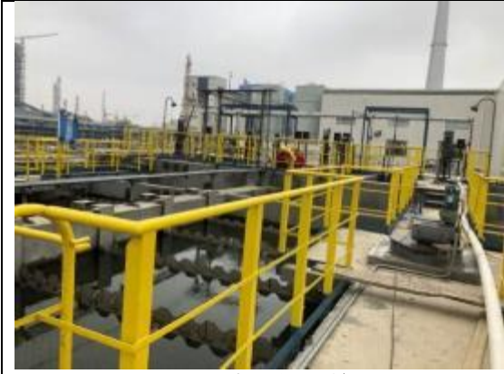
(17) 污水回用设施
