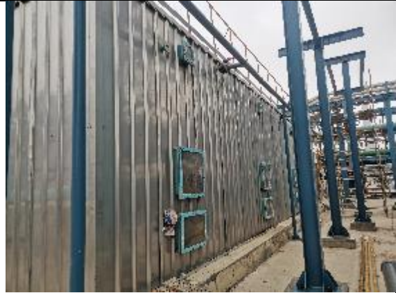
(18) 污水处理厂臭气处理设施
