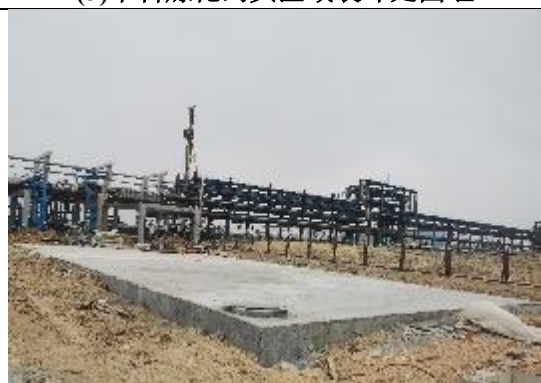
(11) 码头区的污水调节池
