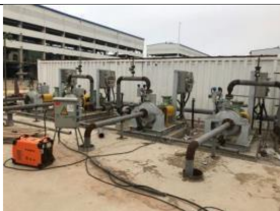
(14) 装置区污水提升泵
