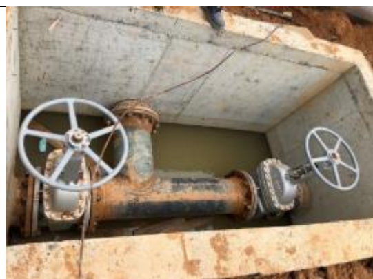
(13) 罐区初期雨水收集池切换阀
