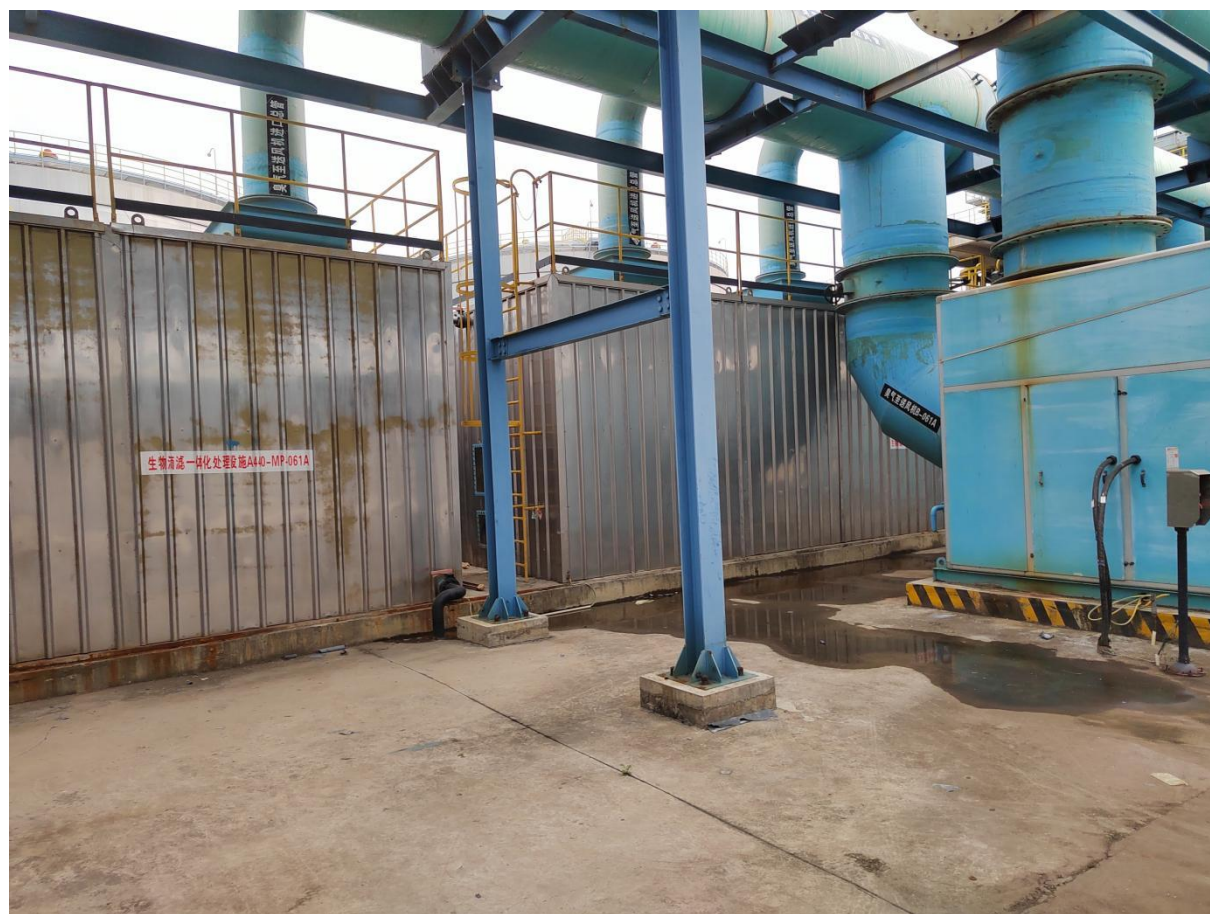
图 2.8-29 中科炼化污水处理场生物除臭工艺
