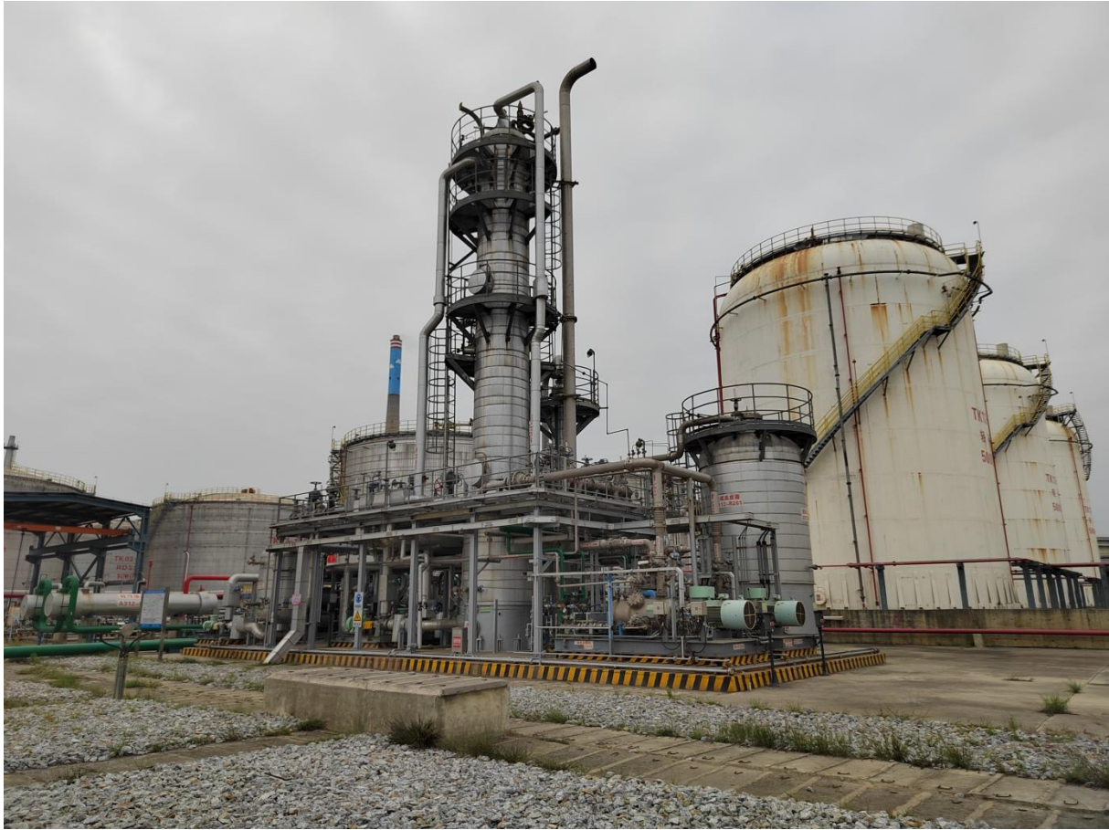
图2.8-2重质油品罐区油气回收装置
