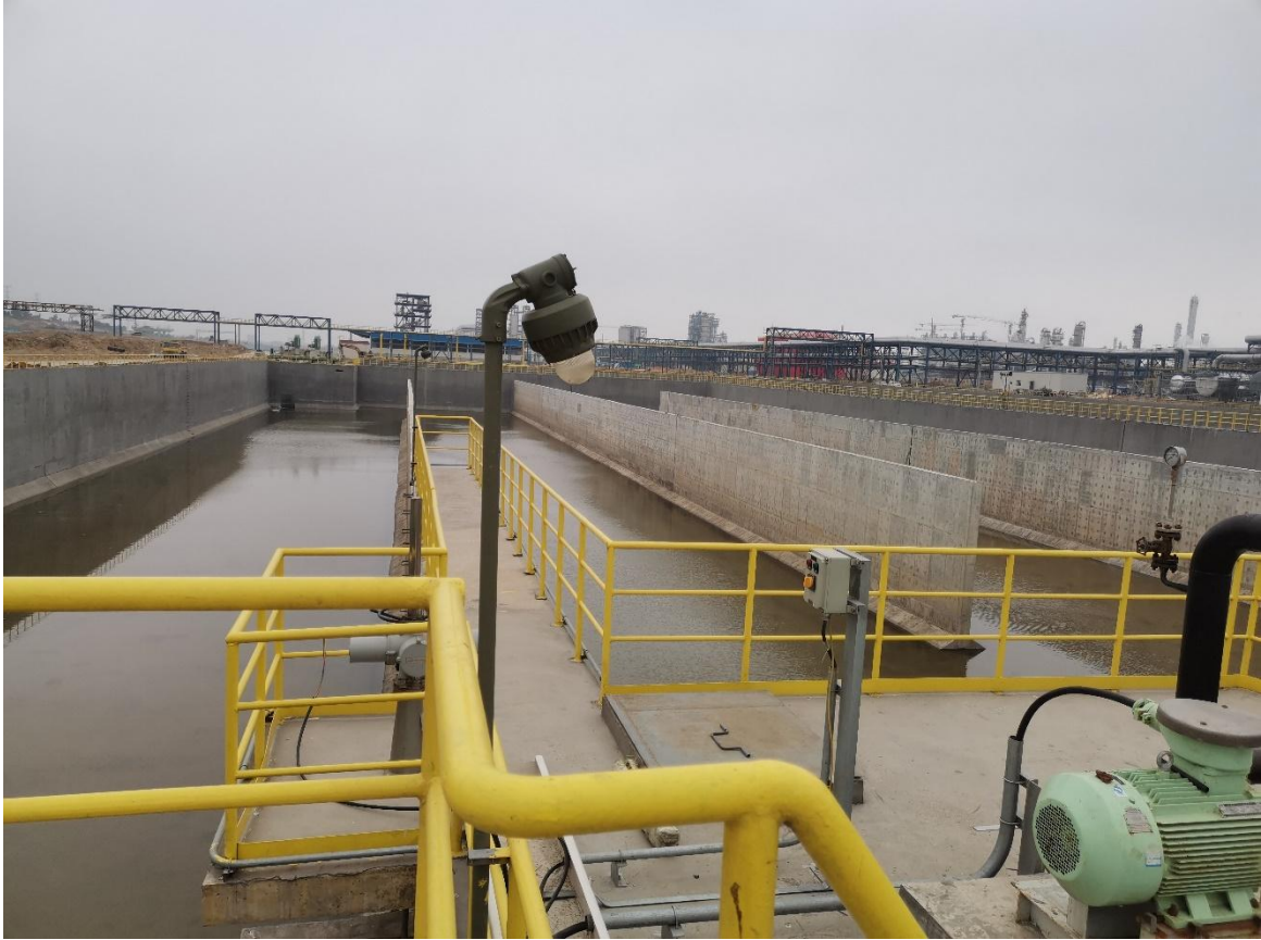
图 2.8-21 中科炼化厂区雨水监控池
