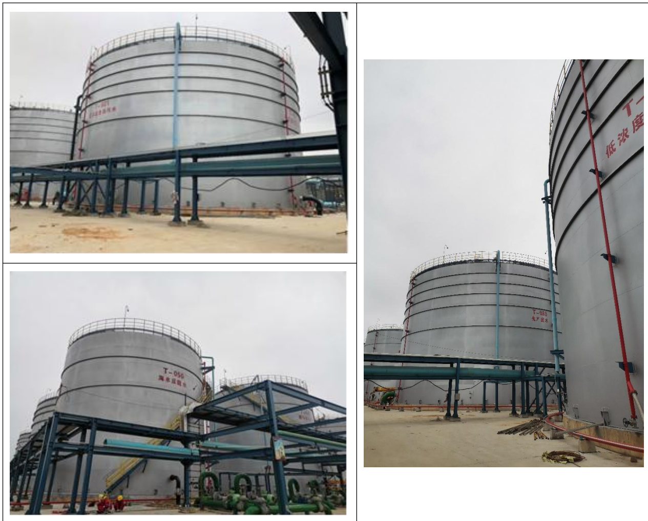
图 2.8-13 中科炼化污水调节罐
