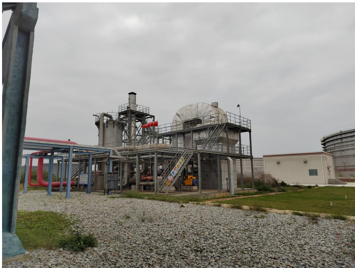
图2.8-1轻质油品储罐油气回收装置
