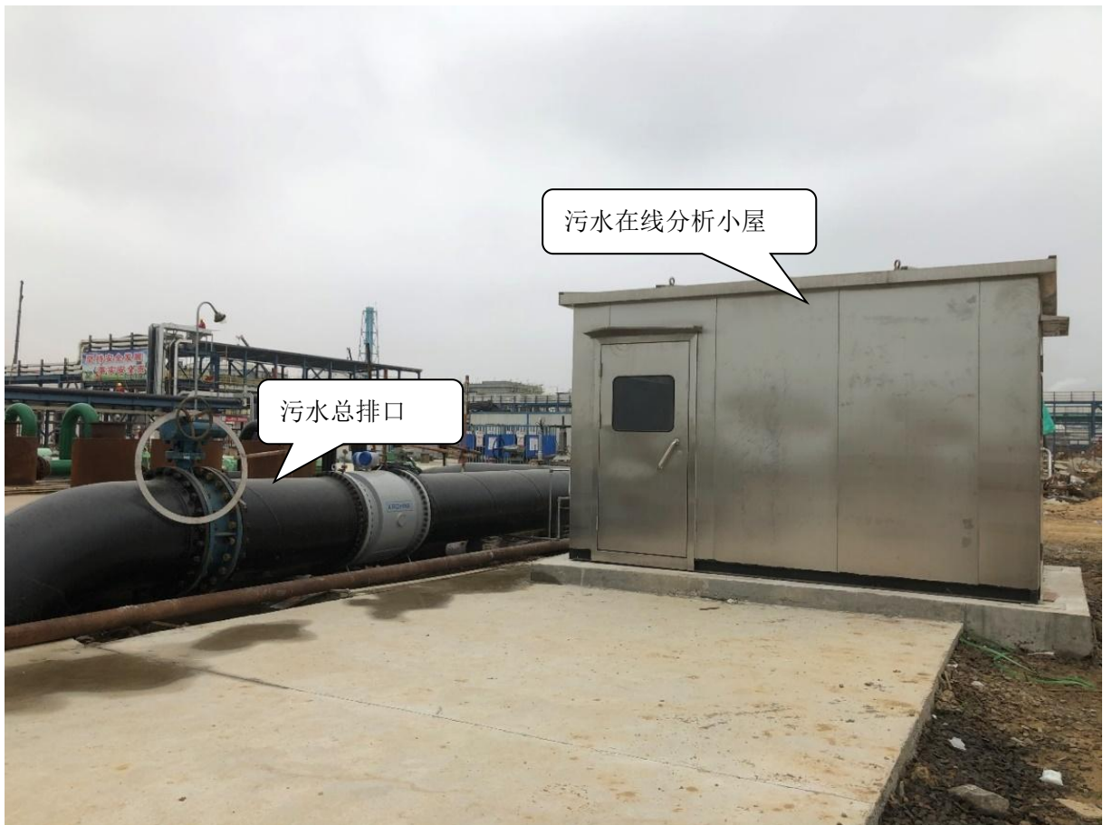
图 2.8-30 中科炼化污水排放口
