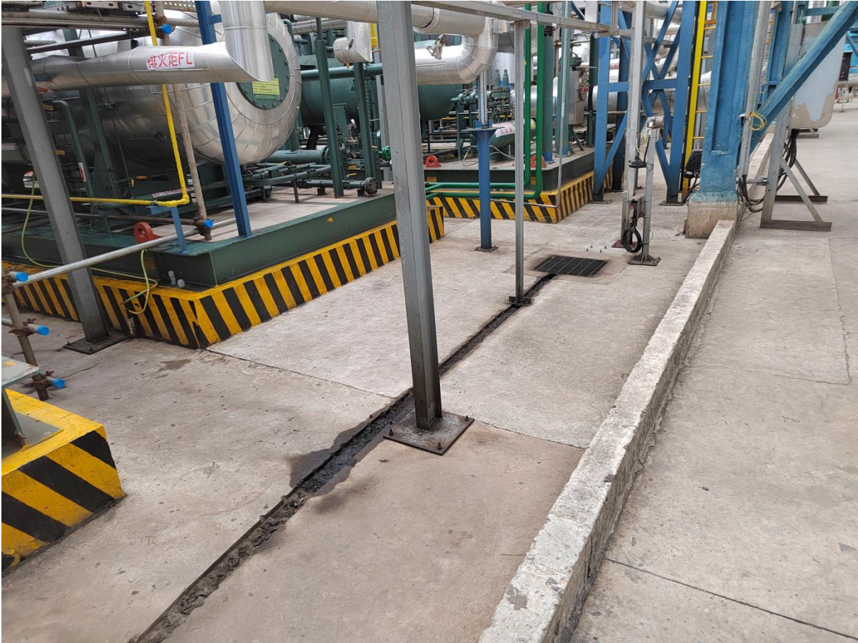
图 2.8-11 中科炼化装置区的小围堰
