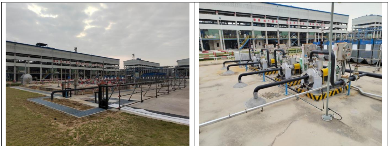
图 2.8-27 中科炼化污水提升池及提升泵
