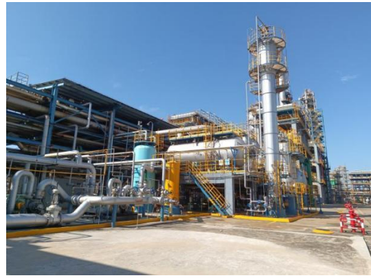
蒸馏车间 500 万吨/年常减压装置
