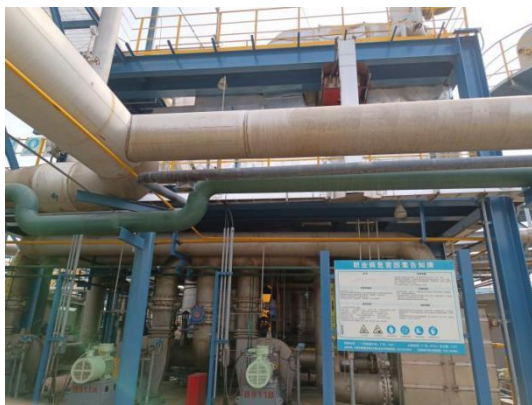
供排水车间废气提标装置
