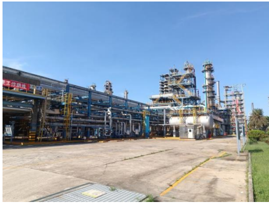
加氢车间 150 万吨/年柴油加氢精制装置 (1#)
