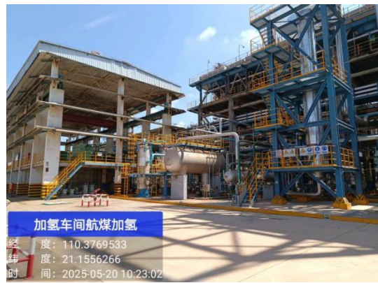
加氢车间 60 万吨/年航煤加氢装置
