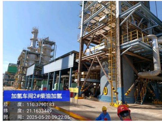
加氢车间 200 万吨/年柴油液相循环加氢装置
