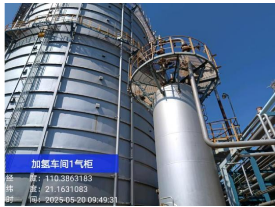
加氢车间 2#气柜
