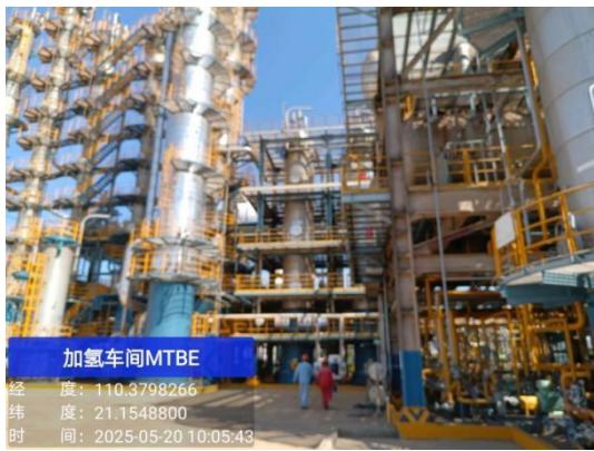
加氢车间 9 万吨/年 MTBE 装置
