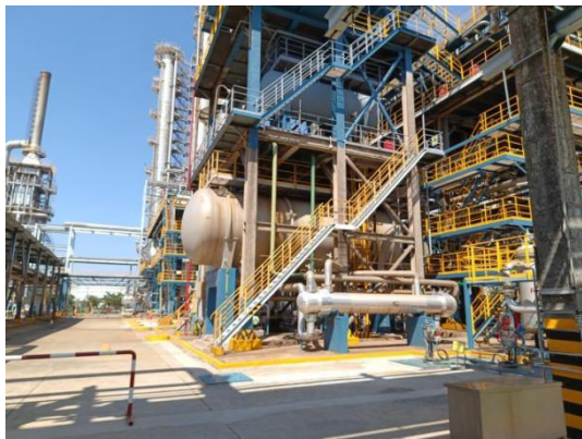
重整车间 75 万吨/年芳烃抽提装置
