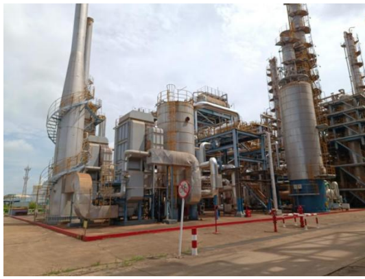
苯乙烯车间乙苯装置
