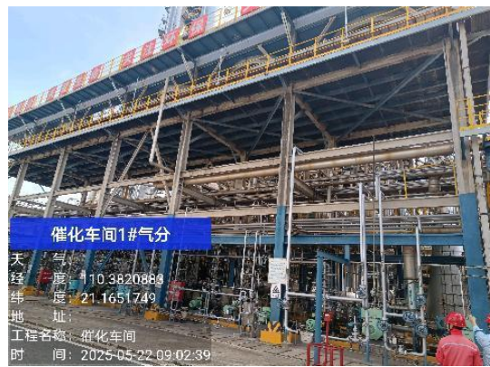
催化车间 10 万吨/年气分蒸馏装置(1#)
