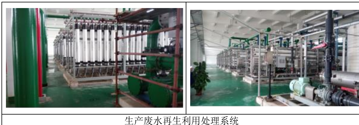
图 8.2-5 中科炼化现有污水处理系统相关设施现场照片（部分）
