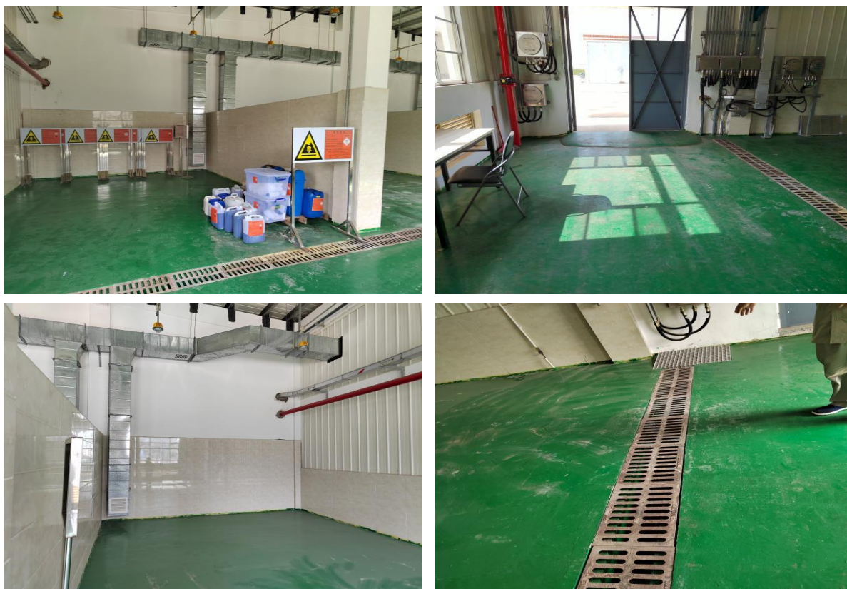
图 8.2-9 危废暂存间现场图片
