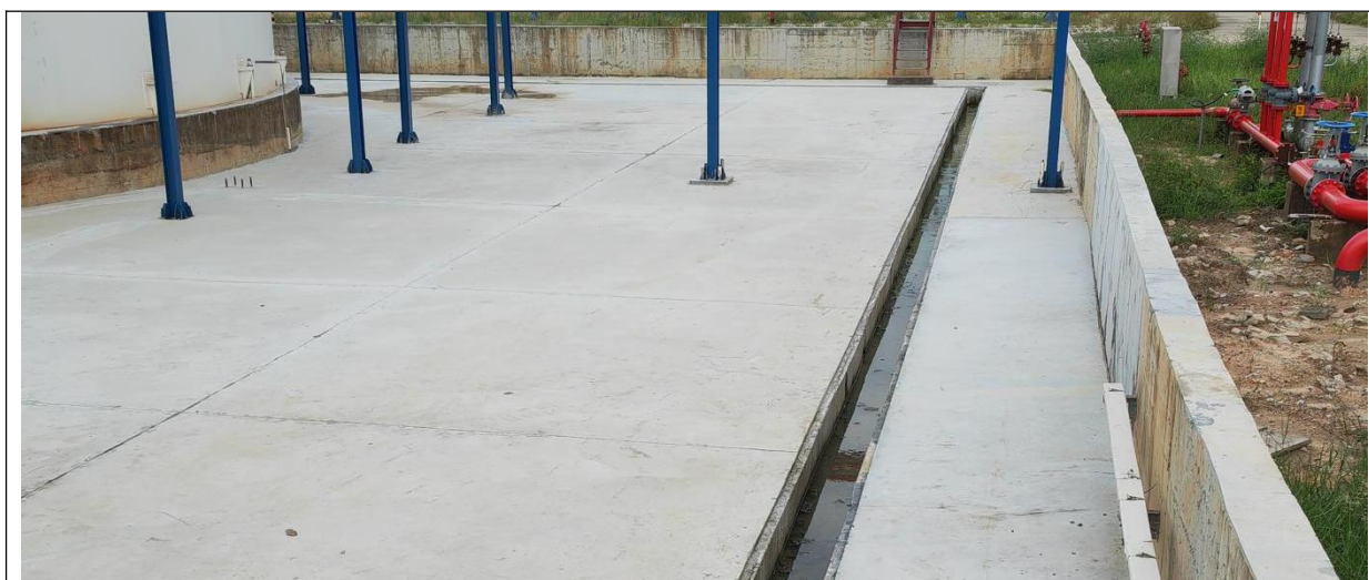
图 4.1-3 含油污水收集渠
