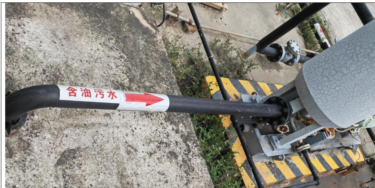
图 4.1-4 含油污水调节罐
