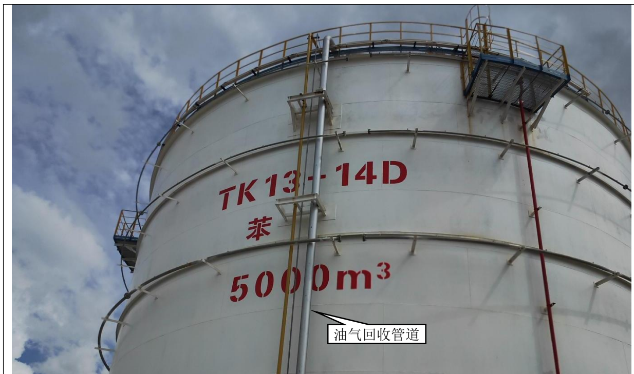
图 4.1-8 苯储罐油气回收管道
