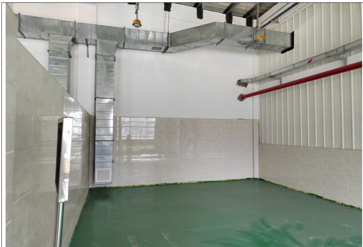
图 4.1-13 危废暂存间抽风设施
